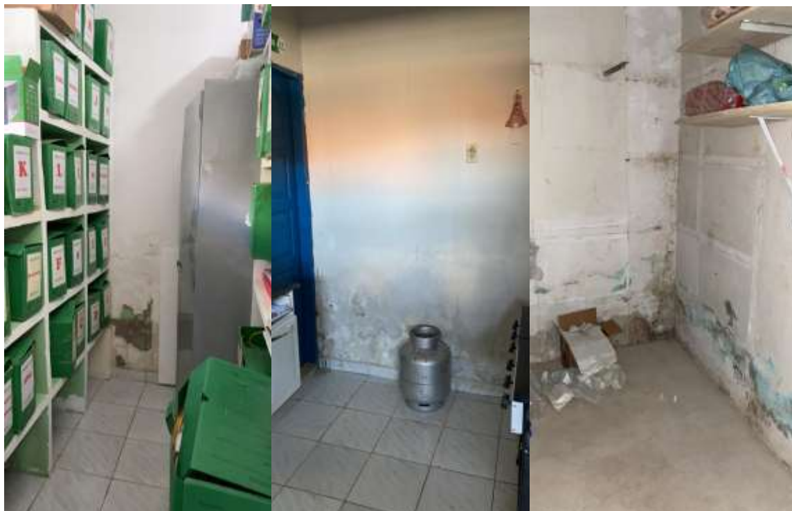
Figura 08 – Diretoria, Almojarifado e Despensa com grau de deterioração avançado nos revestimentos das paredes
