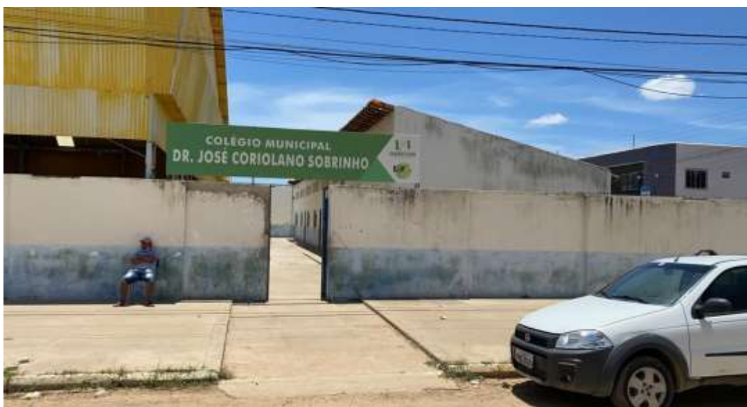
Figura 01 – Fachada atual com infiltrações aparentes
