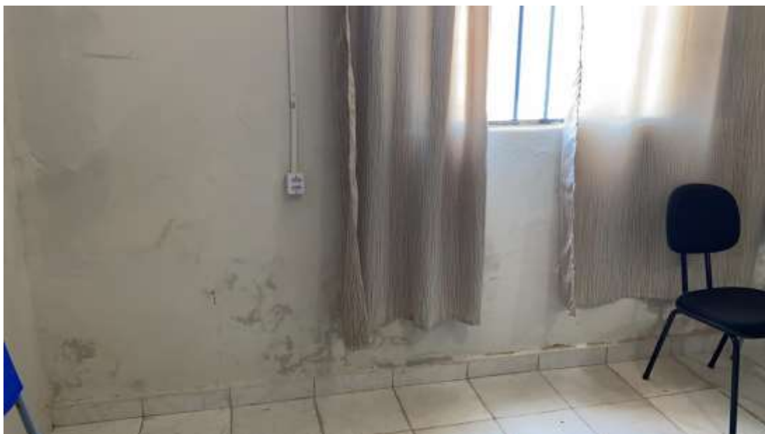
Figura 04 – Sala dos professores com presença de infiltração
