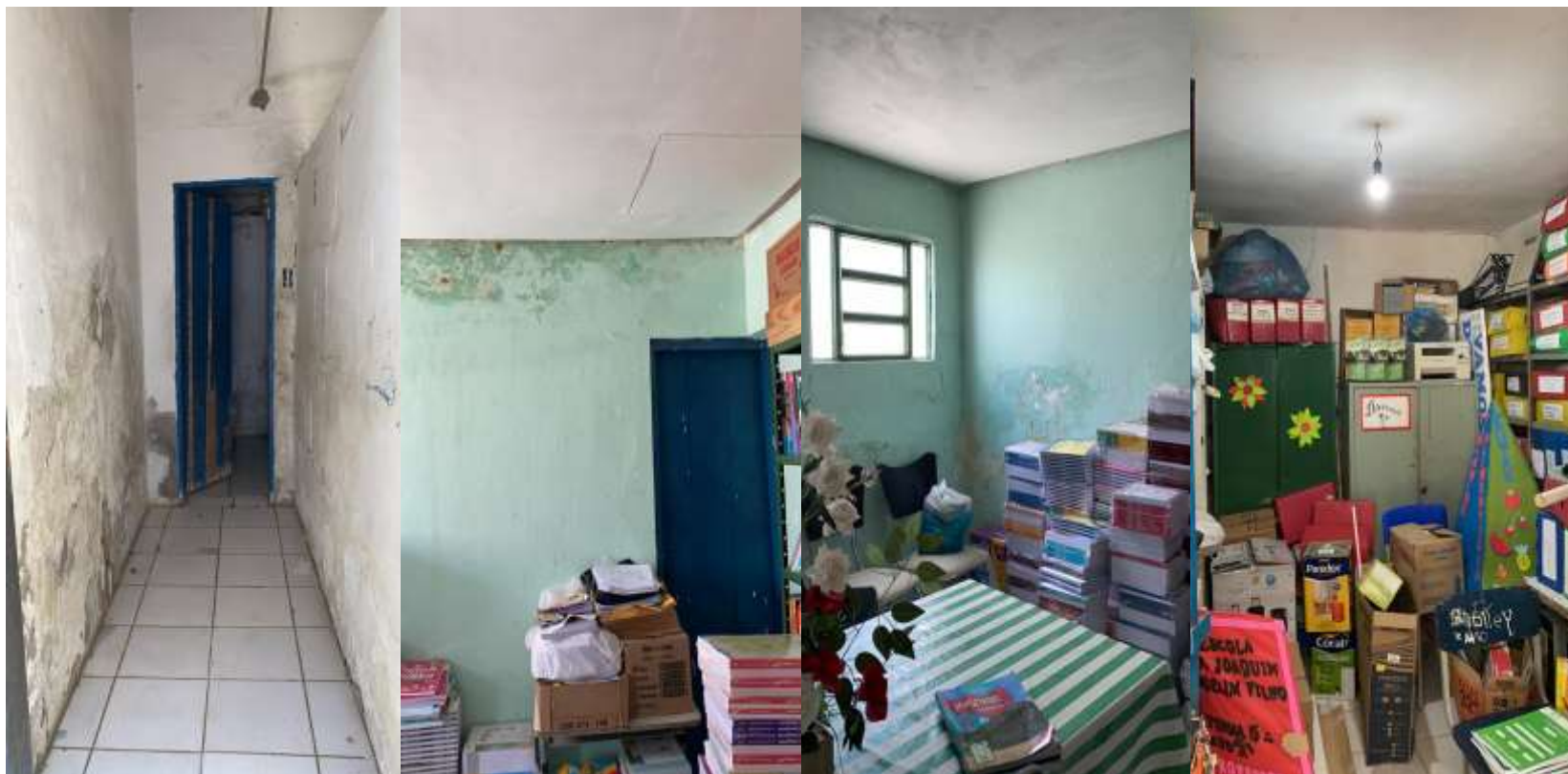
Figura 12 – Circulação e sala usada como Biblioteca com revestimentos do teto e paredes apresentando infiltrações aparentes e patologias
