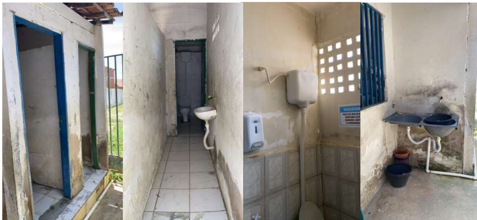
Figura 13 – Banheiros femininos e masculinos com revestimentos danificados e em processo de deterioração, além de acessórios e equipamentos danificados ou sem funcionamento
