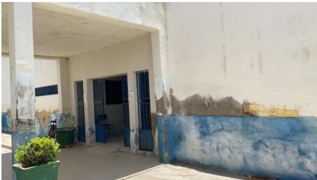
Figura 03 – Entrada do bloco II com presença de infiltração e patologias na estrutura de concreto
