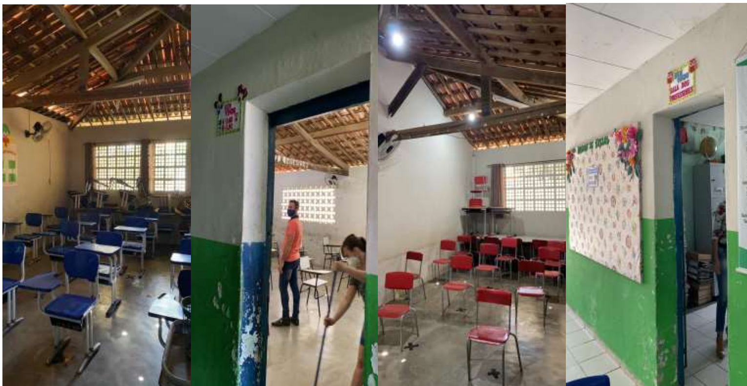
Figura 15 – Salas de aula sem forro e telhado danificado devido a presença de cupins
