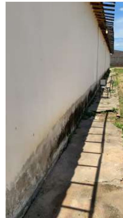
Figura 09 – Circulação externa com infiltração recorrente e coberta sem as telhas do beiral
