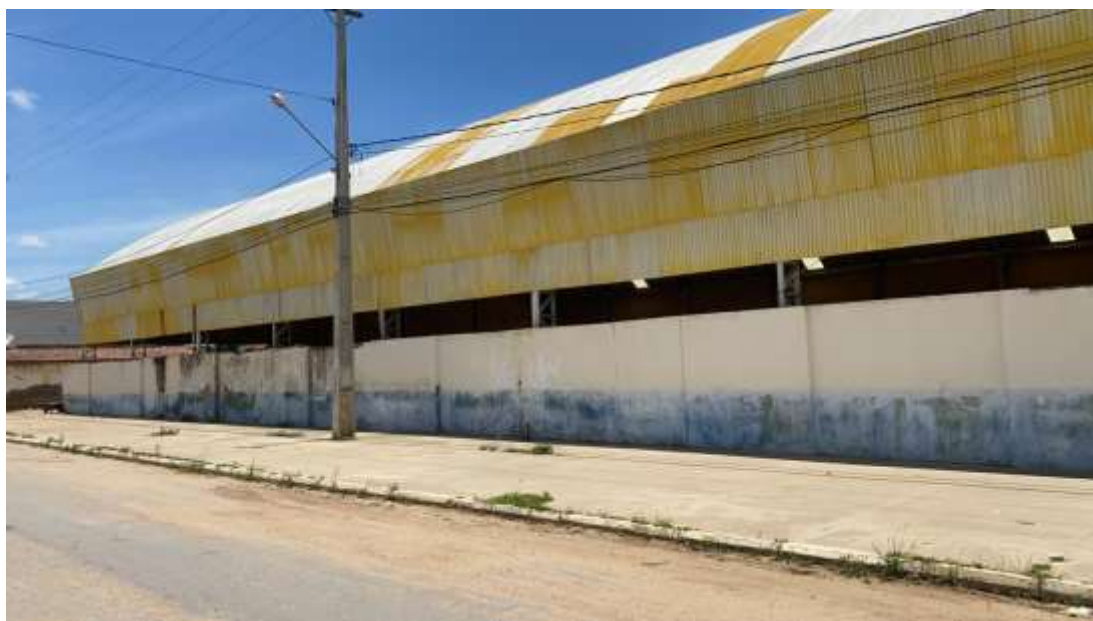
Figura 02 – Muro lateral da escola com infiltração e patologias aparentes
