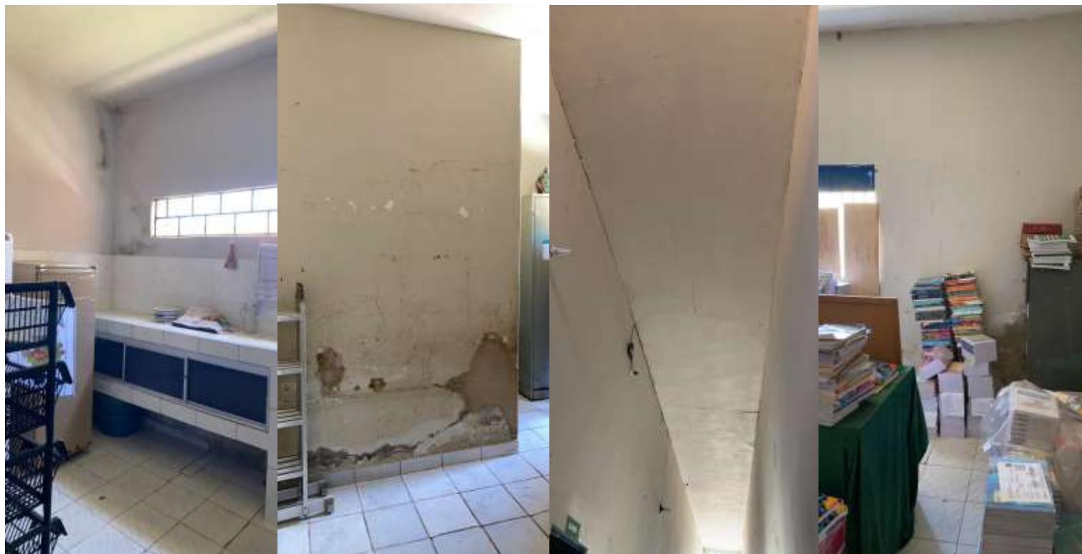
Figura 07 – Copa, Circulação e Biblioteca do bloco II com infiltração e patologias aparentes
