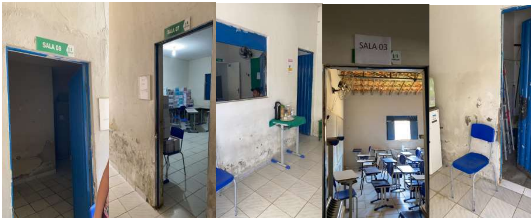
Figura 06 – Salas de aula do bloco II com patologias em estágio avançado e em processo de deterioração
