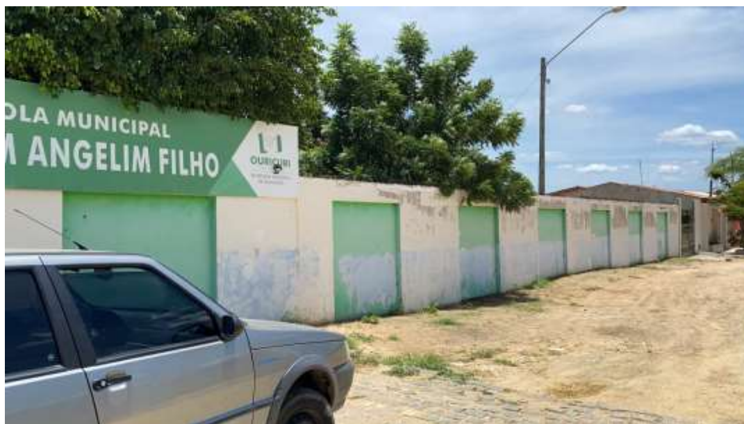
Figura 10 – Fachada com pintura em processo de deterioração
