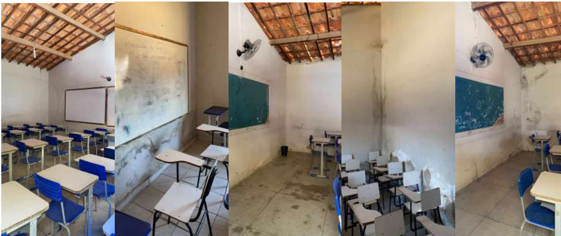
Figura 05 – Salas de aula do bloco I com infiltração e presença de patologias no piso e nas paredes internas, além de recalque pontual na estrutura de concreto em todos os cruzamentos da compartimentação
