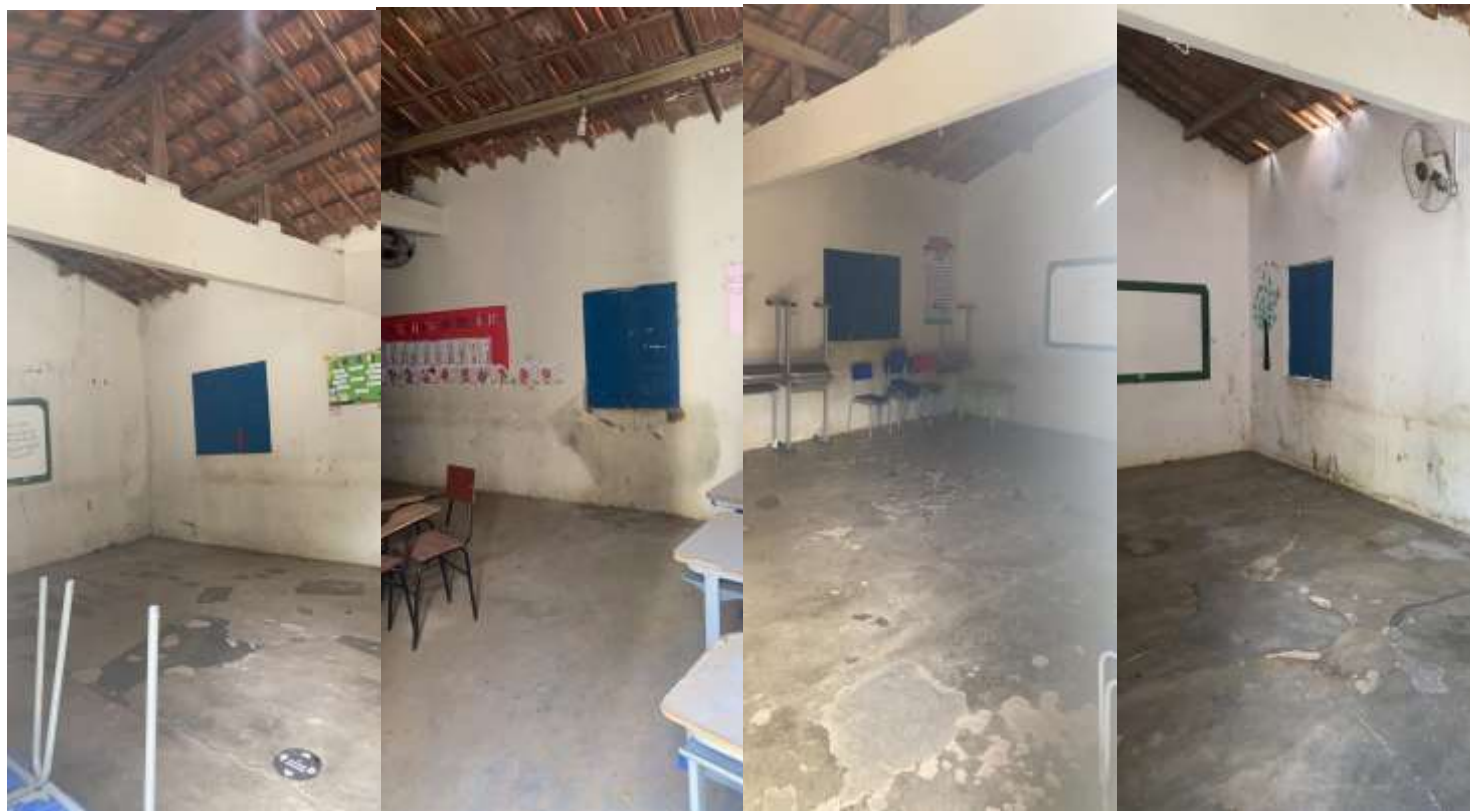
Figura 33 – Salas de aula com revestimento do piso em deterioração, sem forro e com infiltrações aparentes
