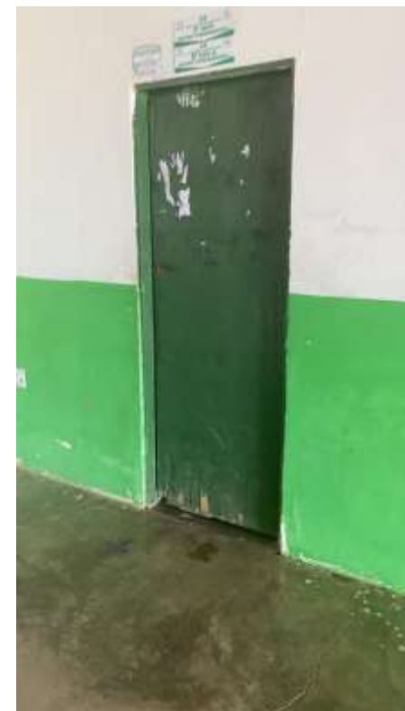
Figura 10 – Sala de aula com porta danificada e sem fechadura
