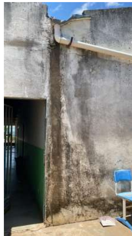
Figura 13 – Calha com saída de águas pluviais ineficiente e paredes externas com patologias aparentes
