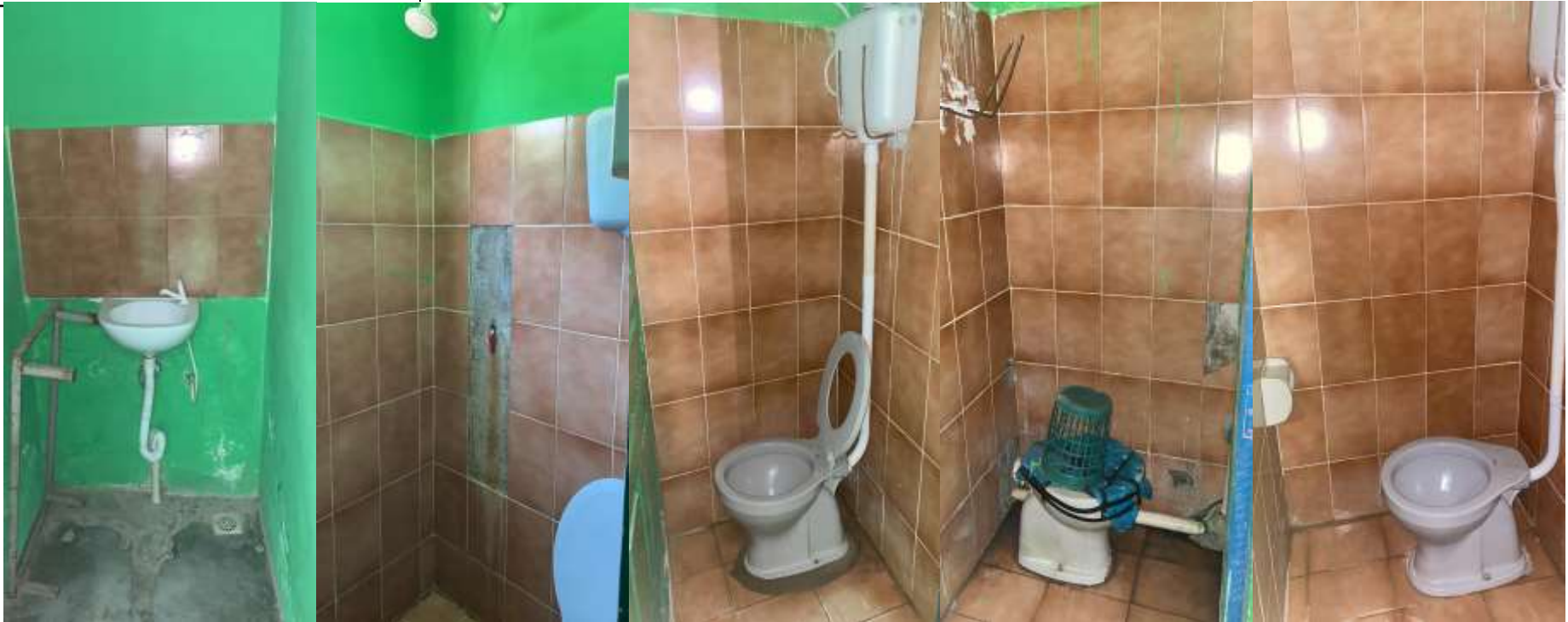
Figuras 11 – Vistas internas dos banheiros feminino e masculino sem funcionamento
