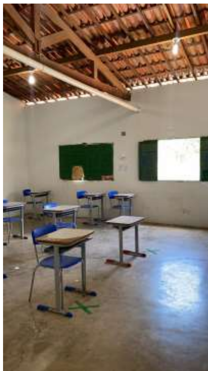
Figura 06 – Sala de aula com janelas quebradas e sem forro
