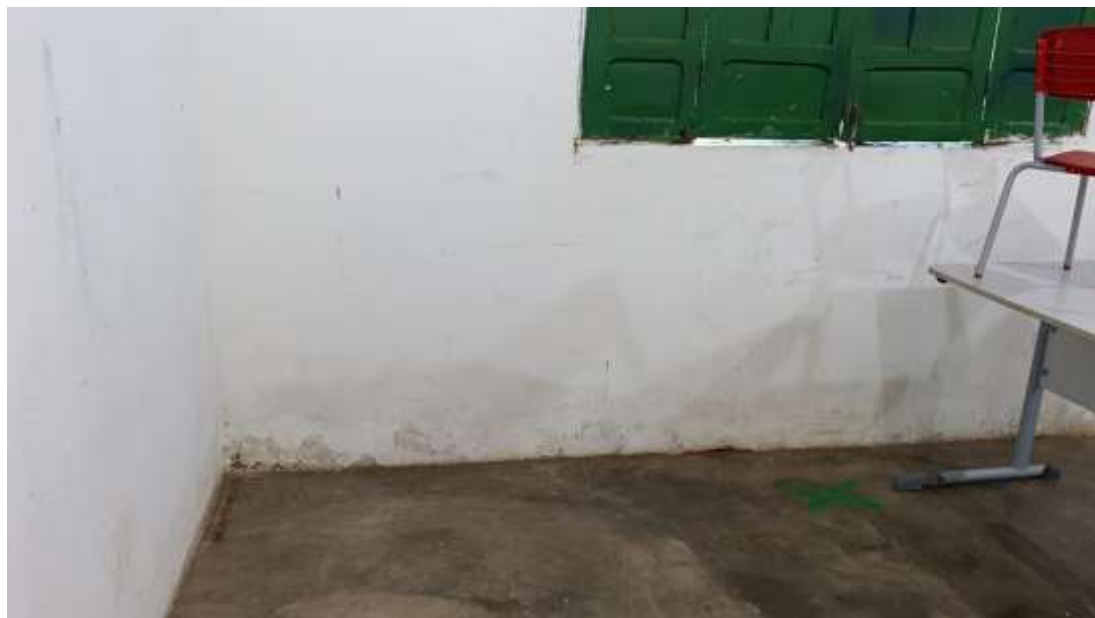
Figura 04 – Canto interno de sala de aula com infiltrações aparentes
