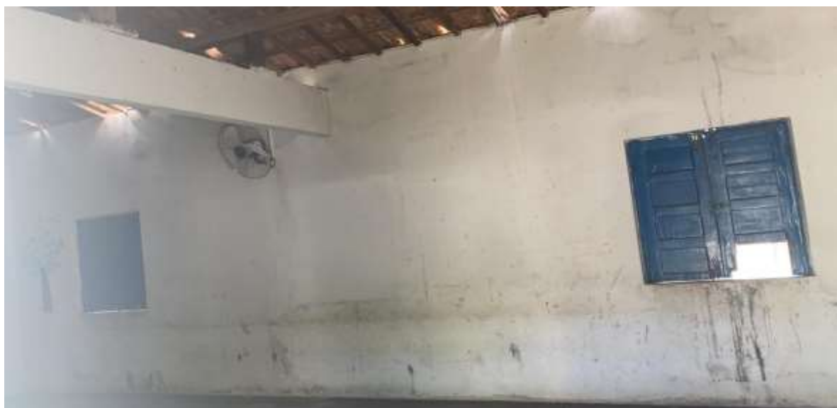
Figura 32 – Sala de aula com infiltração aparente e janela quebrada
