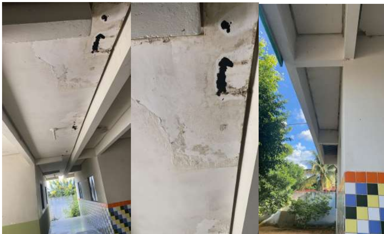
Figura 37 – Circulação do pátio e salas de aula com teto danificado devido infiltrações recorrentes e intensas causados por falta de escoamento e direcionamento das águas pluviais na cobertura
