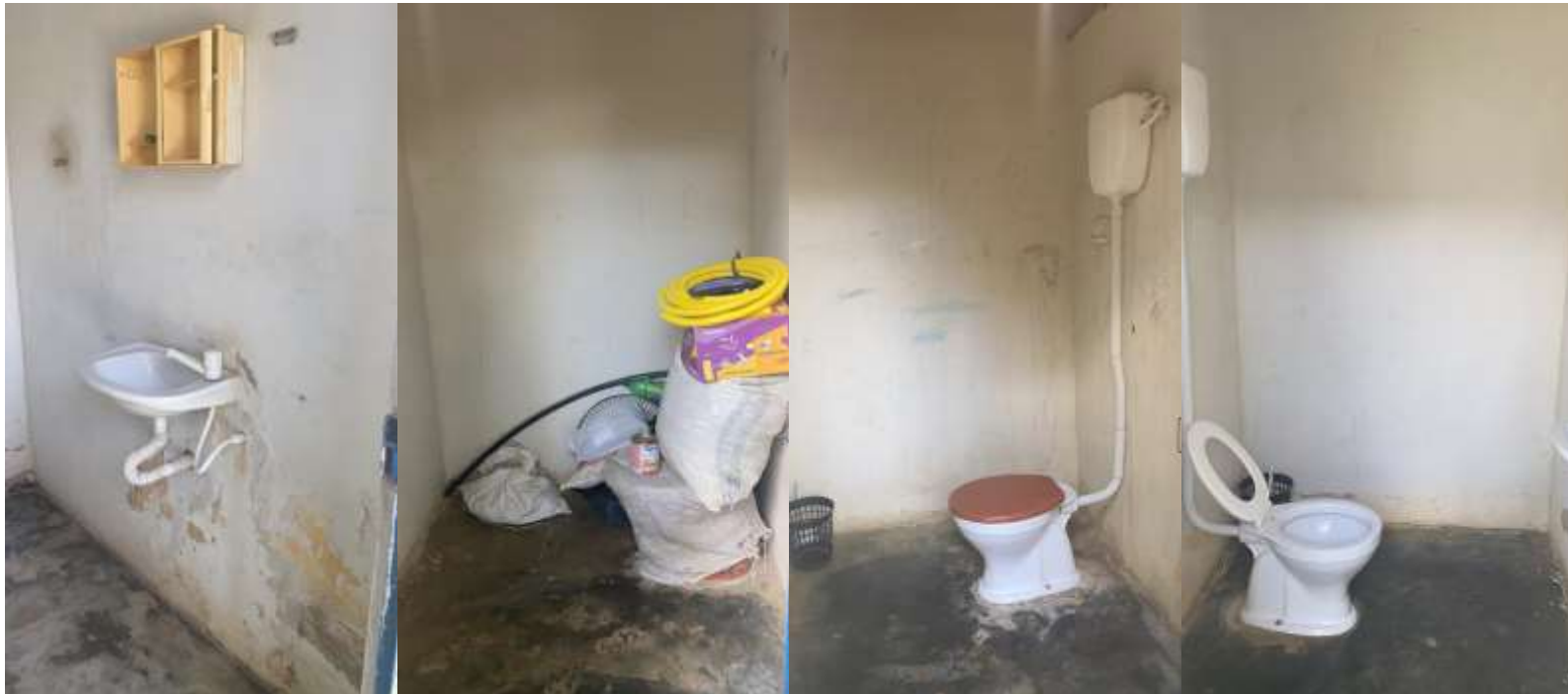
Figura 36 – Banheiros feminino e masculino desativados
