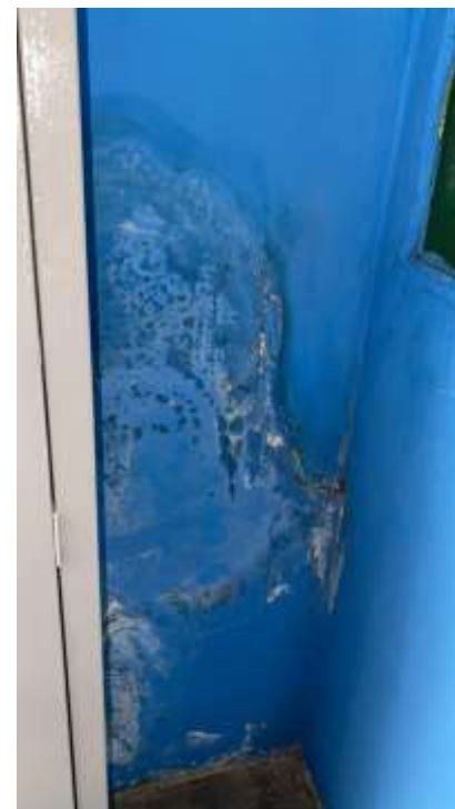
Figura 07 – Parede interna da secretaria com infiltração aparente
