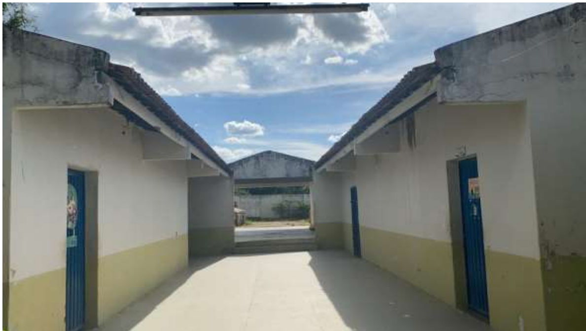
Figura 31 – Circulação com cobertura sem saída de águas pluviais e com infiltração
