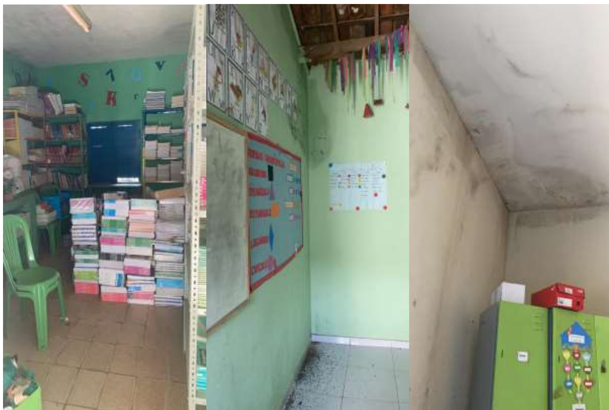
Figura 35 – Biblioteca e sala dos professores com infiltrações aparentes e comprometendo teto e paredes
