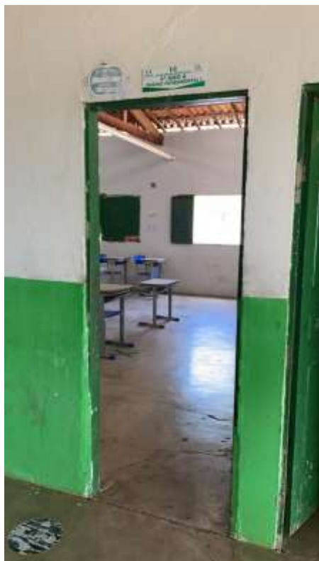
Figura 08 – Sala de aula sem porta
