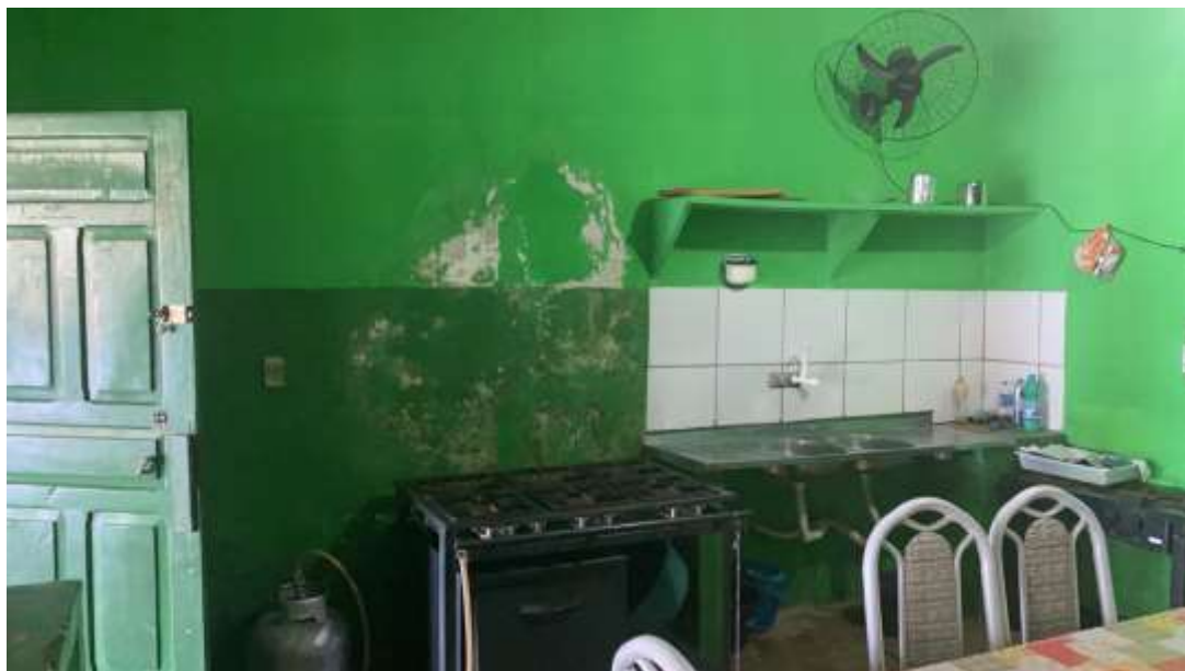
Figura 03 – Cozinha com infiltração em parede revestida em argamassa
