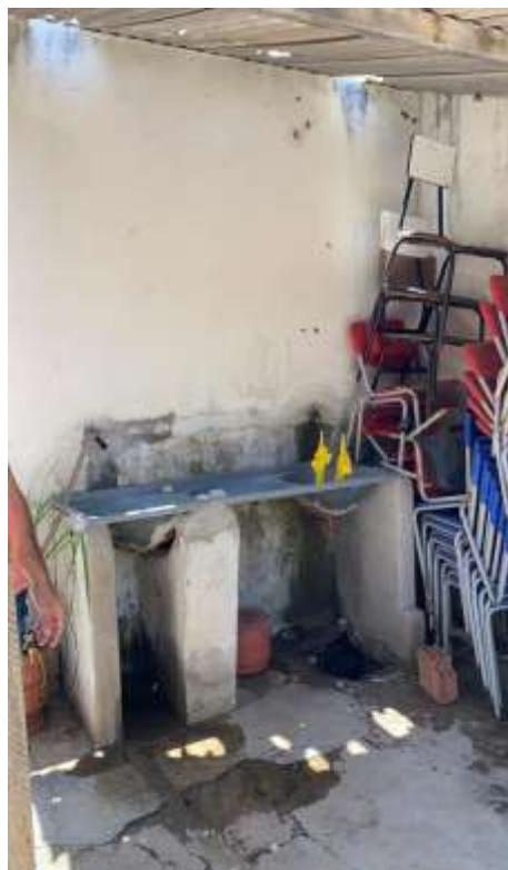
Figura 12 – Lavanderia em desuso
