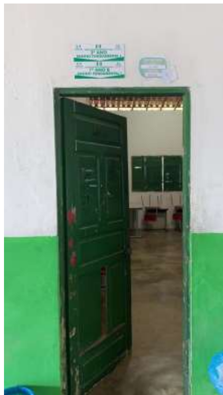
Figura 09 – Sala de aula com porta danificada
