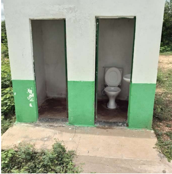
Foto 61 – Banheiros exist.: assentamento de revet. Cerâmico. Construção de mais 02 (dois) banheiros, sendo um para PCD.
