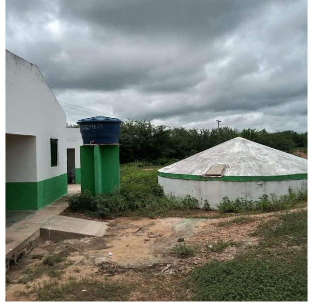
Foto 58 – Readequar rampa e calçada de acordo com parâmetros normativos.
