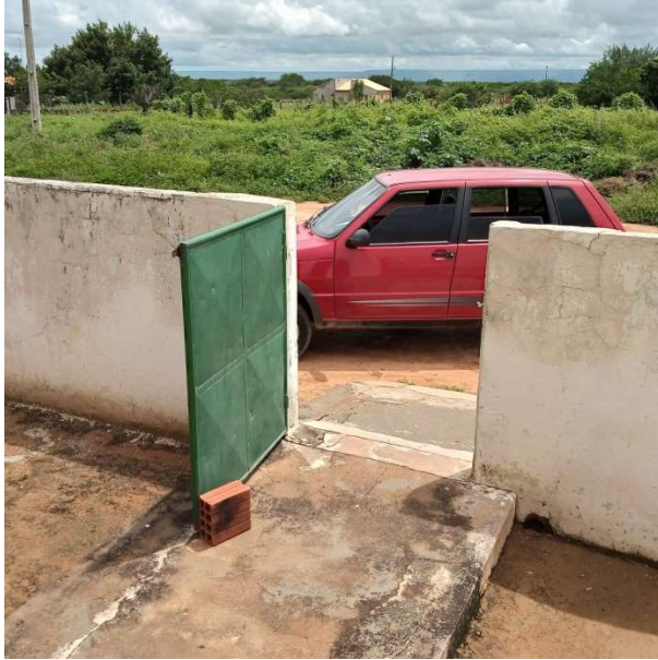
Foto 38 – Readequar rampa e entrada de acordo com parâmetros normativos.
