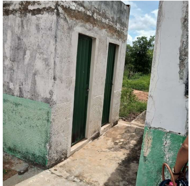
Foto 8 – Banheiros: assent. de revest. cerâmico mais instalação de peças faltantes. Construção de mais 2 (dois) banheiros.
