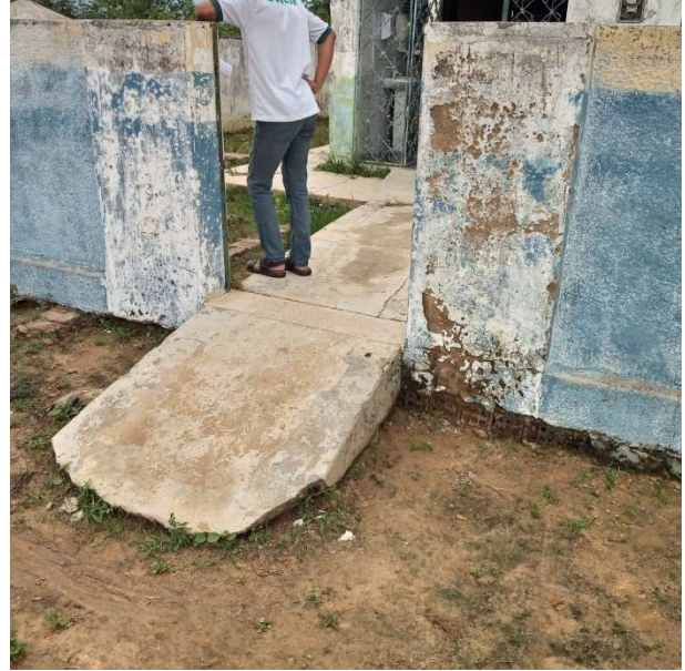
Foto 46 – Readequar rampa e entrada de acordo com parâmetros normativos.
